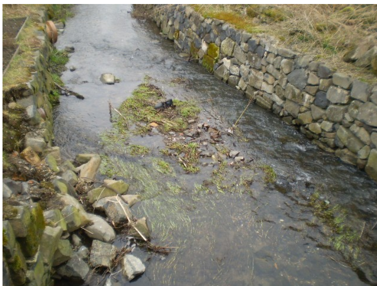
Zřícený břeh potoka u č.p. 43
